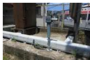
障害物検知装置（施工後）
