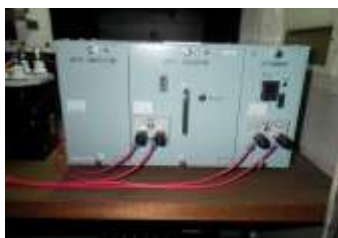
軌道回路（更新後）
