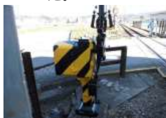
踏切遮断機（更新後）
