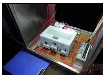
軌道回路（更新後）
